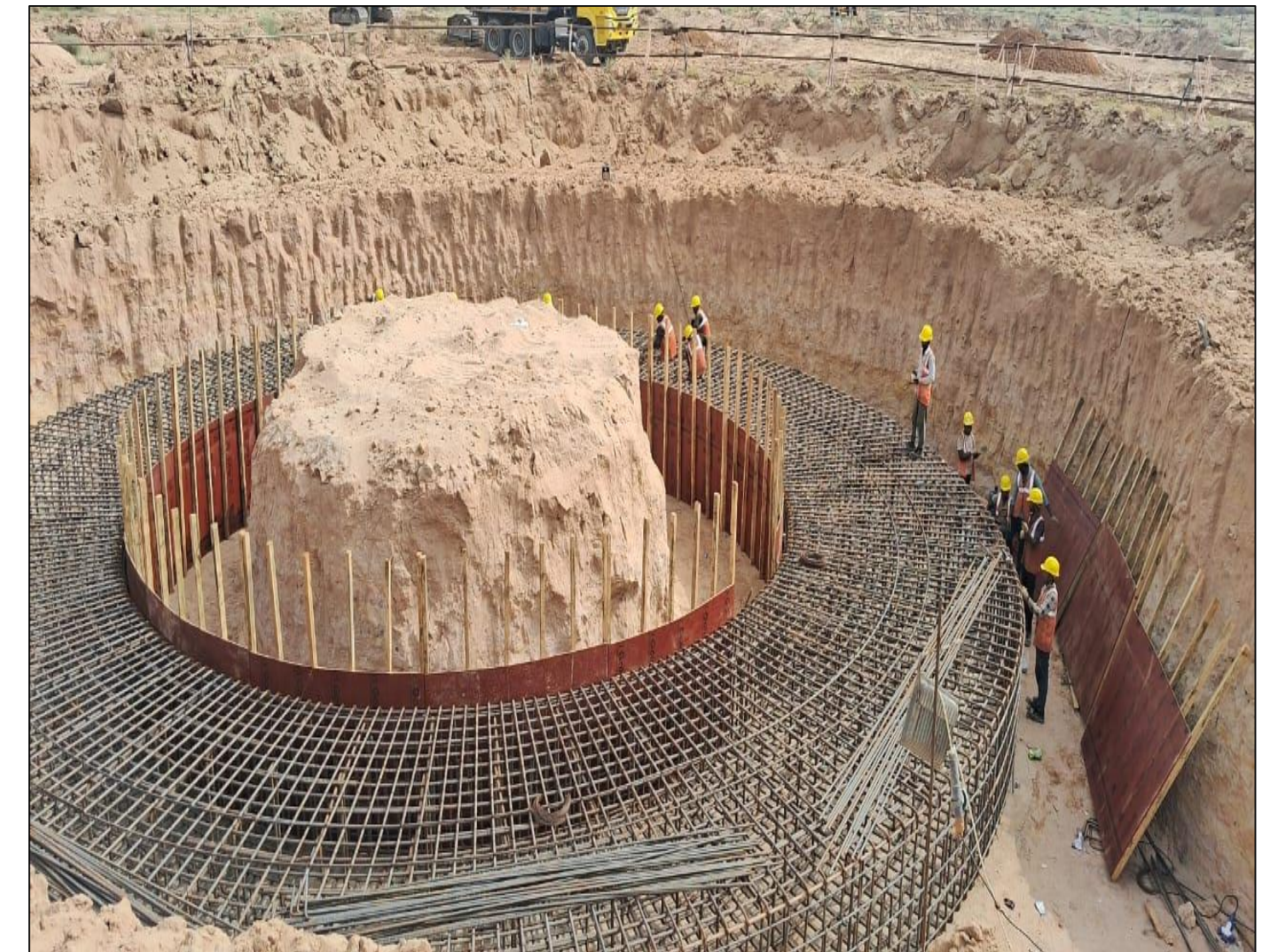
Fly Ash Silo
